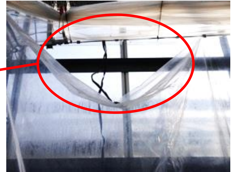
写真7：カーテンとの隙間
