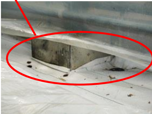
写真9：サイドの隙間
