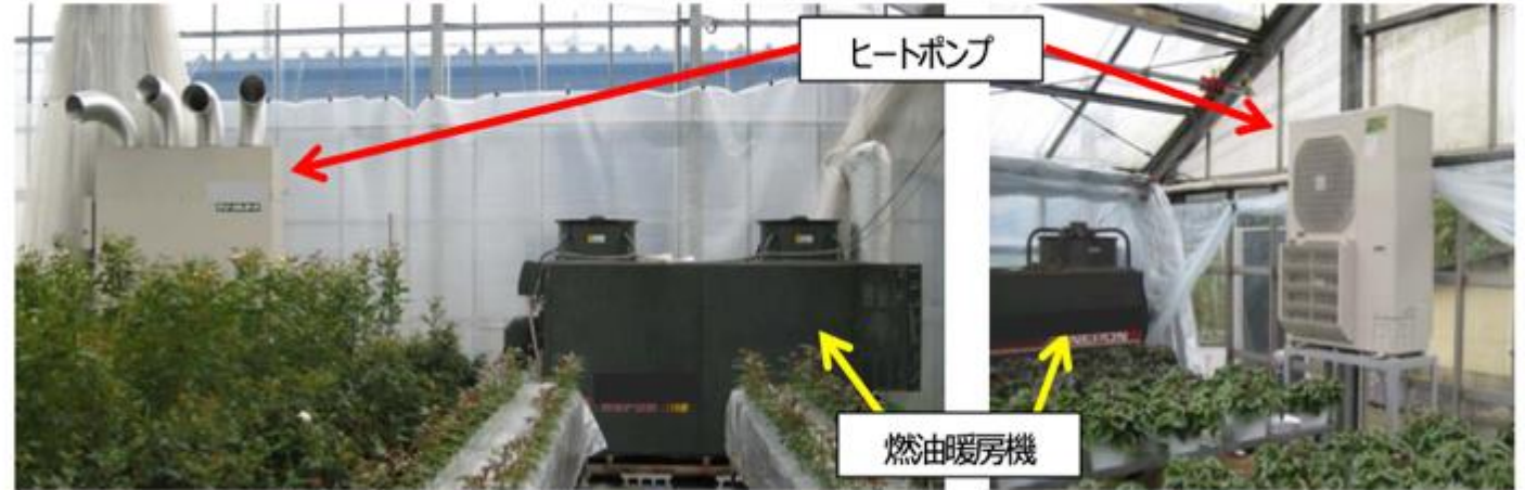
ヒートポンプと燃油暖房機のハイブリッド運転
